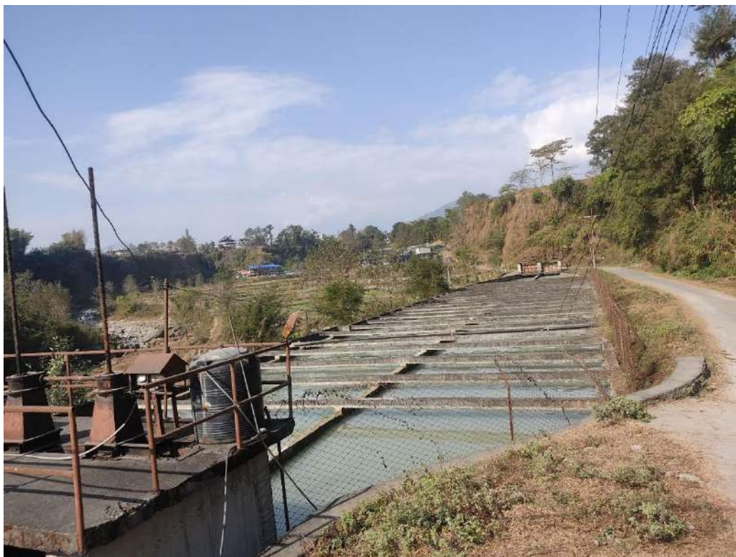
तस्विर ९: विजयपुर-९ साना जलविद्युत आयोजनाको डिसिल्टिङ बेसिन (Desilting Basin)
