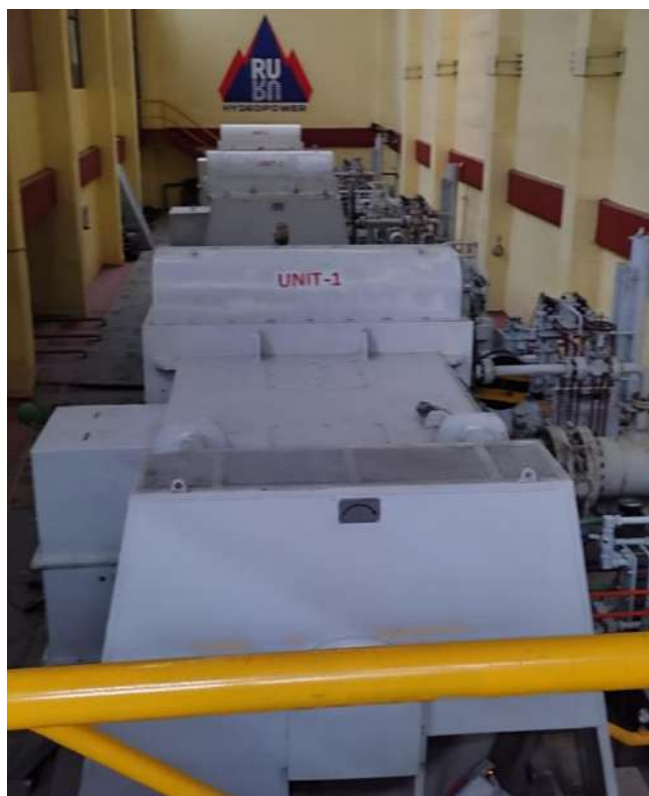
तस्विर २६: माथिल्लो हुग्दी खोला जलविद्युत आयोजनाको विद्युत उत्पादन गृहमा रहको टर्बाइन-जेनेरेटर सेटअप
