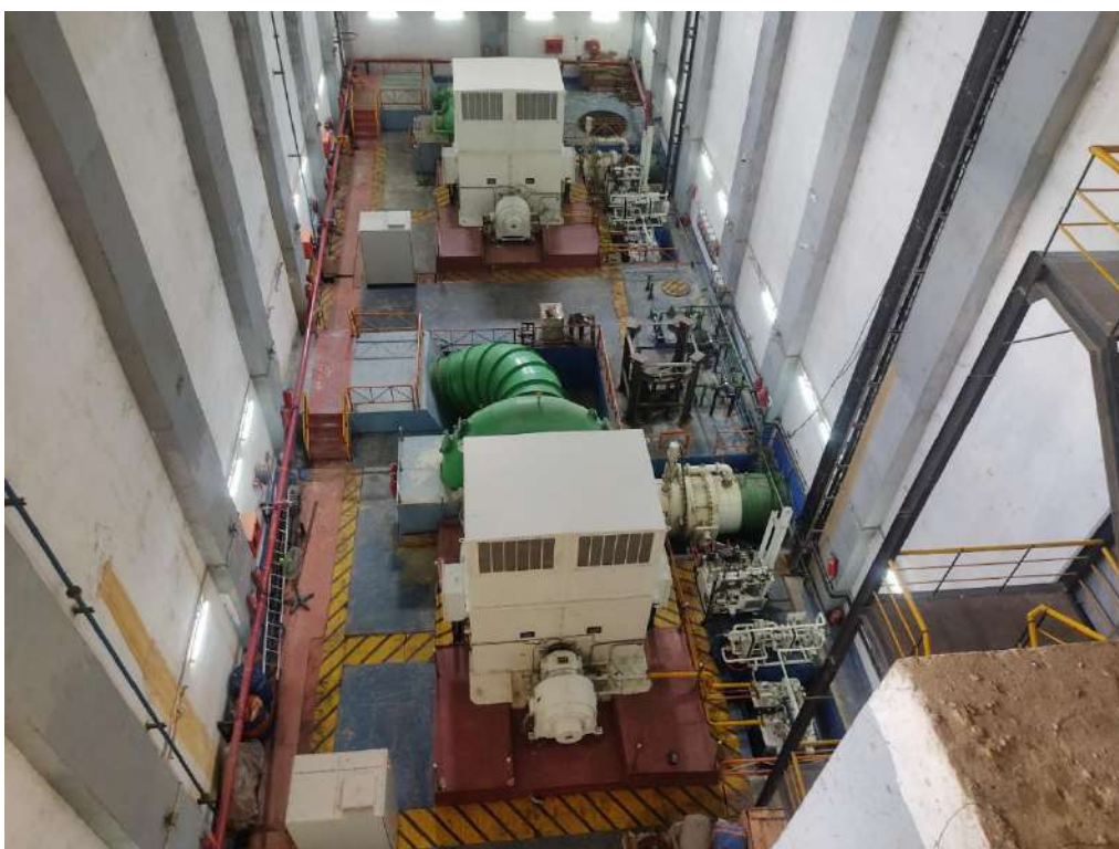
तस्विर ८: तल्लो मोदी खोला जलविद्युत आयोजनाको विद्युत गृहमा रहेका इलेक्ट्रोमेकानिकल सेटअप
